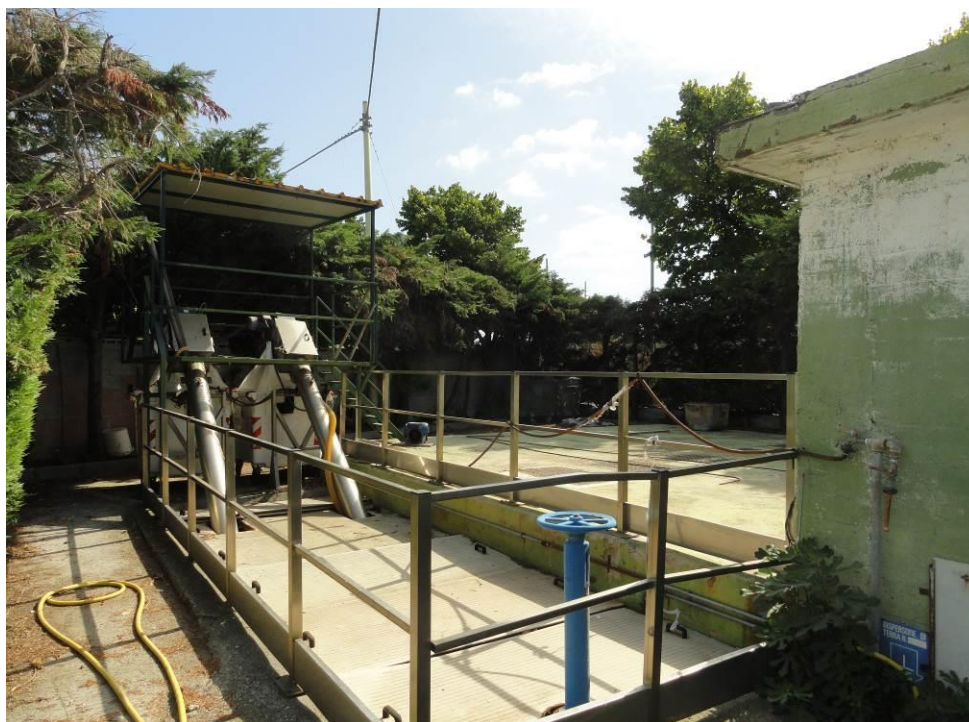
Figura 13 – impianto di sollevamento esistente di via 8 Marzo in comune di Albenga
